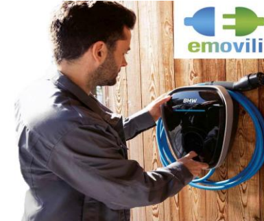
Instalación Wallbox. Garaje Comunitario(7,4kW) 1.490€
