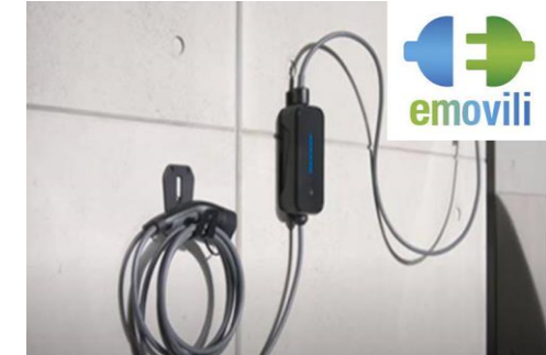
Instalación FFCharger (3,7kW limit 20 mts.) 966€
